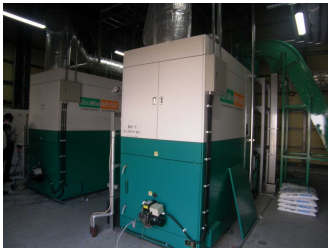
チップボイラー
